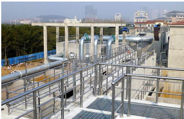
Biofiltrationsanlage einer chinesischen kommunalen Kläranlage.
